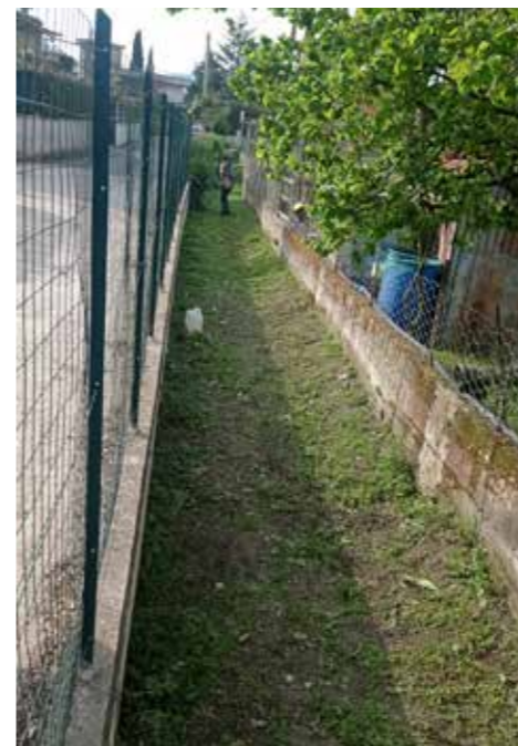
Canale Viara – Comune di Montoro Sfalcio manuale della vegetazione infestante presente sul fondo alveo Ripristino sezione idraulica con mezzi meccanici
