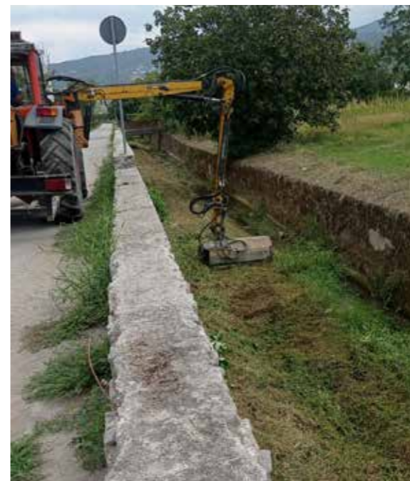
Fiumicello Borgo – Comune di Montoro Sfalcio meccanico della vegetazione infestante presente sul fondo alveo
