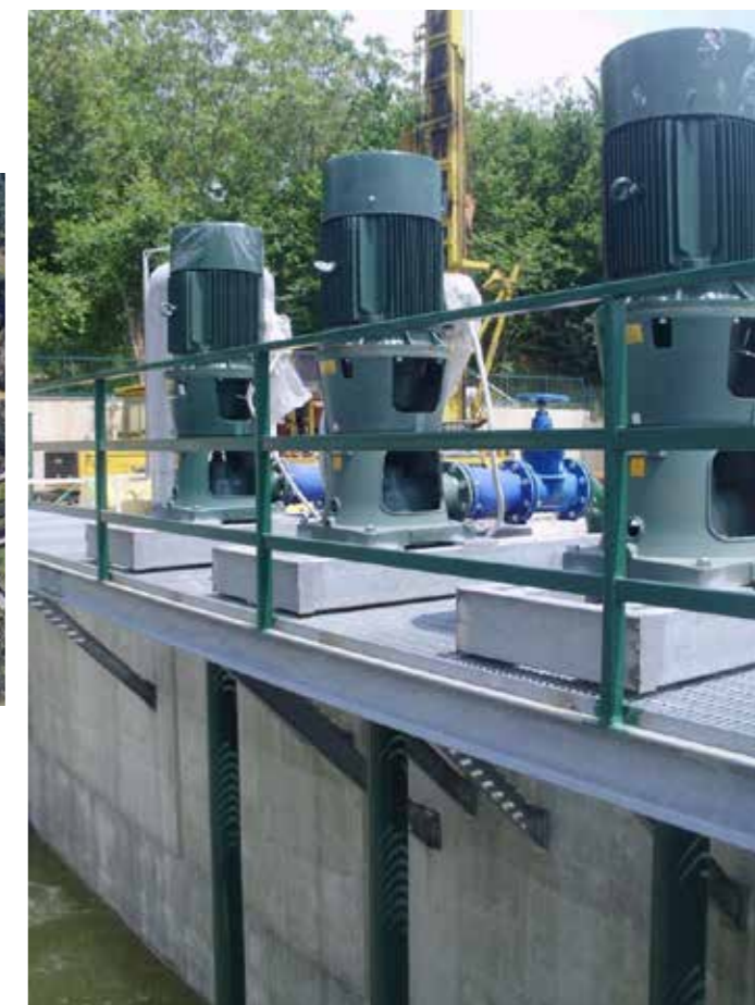
Nuovo Impianto Starza - stazione di pompaggio
