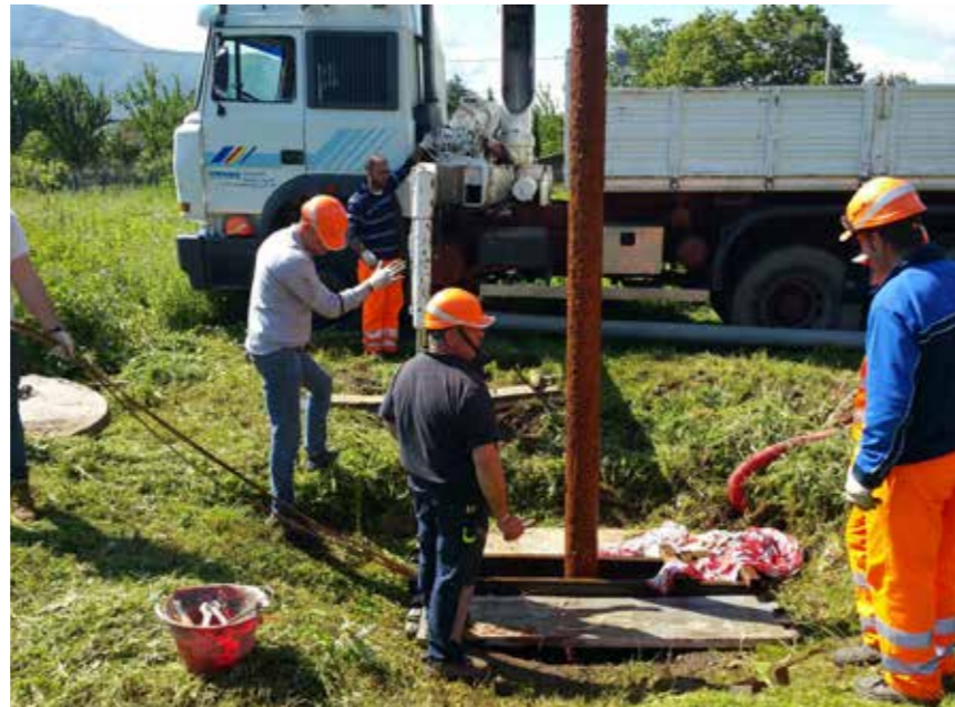
Eduzione elettropompa per manutenzione ordinaria
