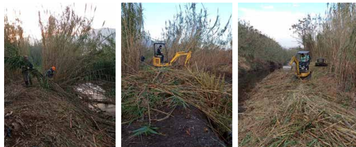
Alveo Comune Nocerino – Comune di San Marzano sul Sarno Sfalcio meccanico e manuale della vegetazione infestante presente sulle sponde (tratto finale) Raccolta e smaltimento dei rifiuti abbandonati nelle aree di pertinenza
