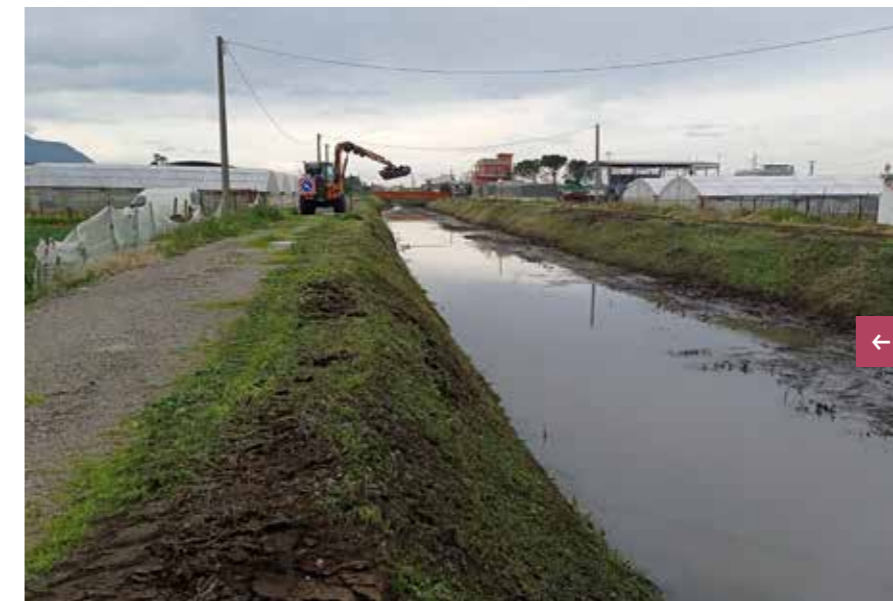
Canale Marna – Comuni di Sant’Antonio Abate, Scafati e Pompei (2° intervento) Sfalcio meccanico della vegetazione infestante presente sul fondo alveo e sulle sponde Ripristino sezione idraulica con mezzi meccanici
