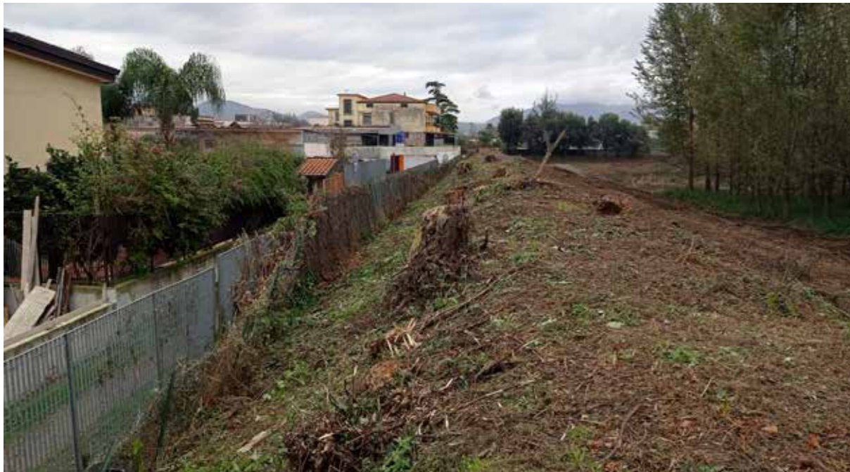
Vasca Santa Lucia – Comune di Anгри Sfalcio meccanico della vegetazione infestante presente sul fondo alveo Raccolta e rimozione di rifiuti abbandonati nelle aree di pertinenza
